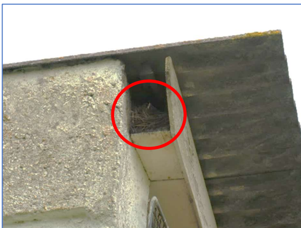
Abb. 13 Nischenbrüternest im offenen Dachkasten.
