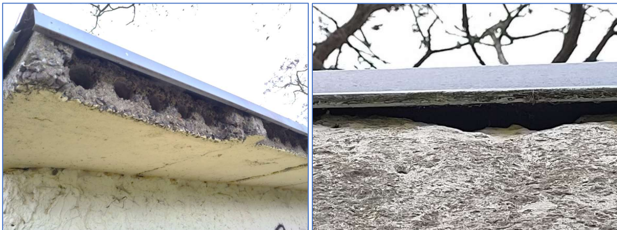
Abb. 14 und 15 Pot. Fledermausverstecke im Dachbereich.
